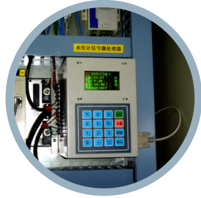
安装在现场控制器
