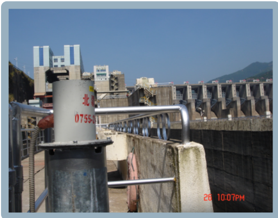
福建水口电站船闸激光传感器安装现场
